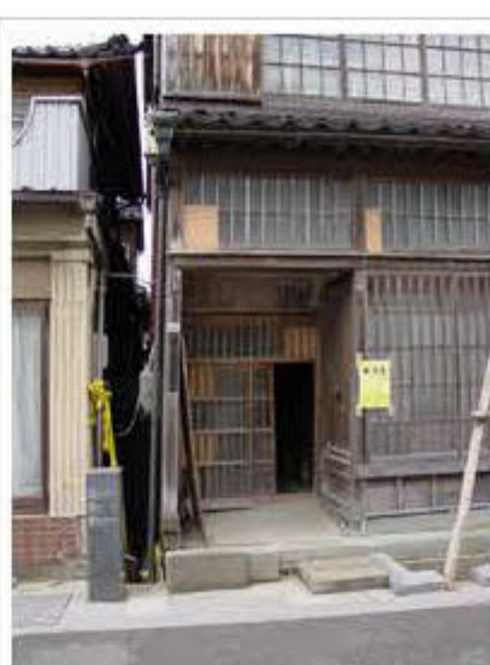
震災直後の大崎漆器店 家が傾いている。
