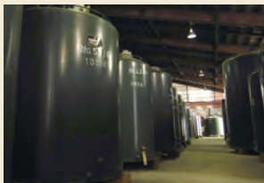
地震で傾いた貯蔵タンク
